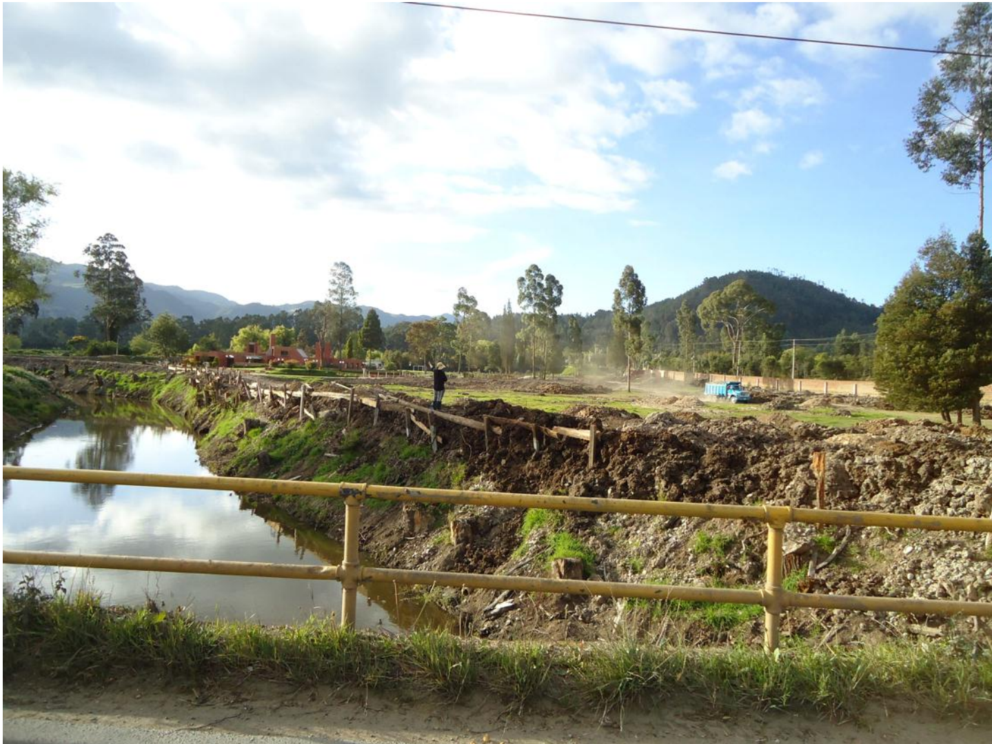
Dique con tambres y destrucción total de los árboles, relleno con escombros. Puente sobre el río Frío, vía Cajicá – Tabio, cruce a El Bote
