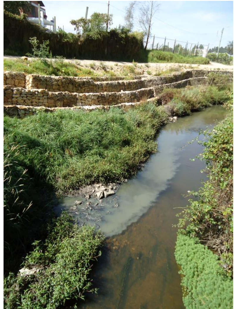
Alcantarillado zona suburbana en Colegio Manyanet – El Darién (04/05/2015)
